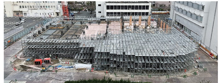
南側から見た新本館棟の様子。現在、2階まで施工が進んでいます。
